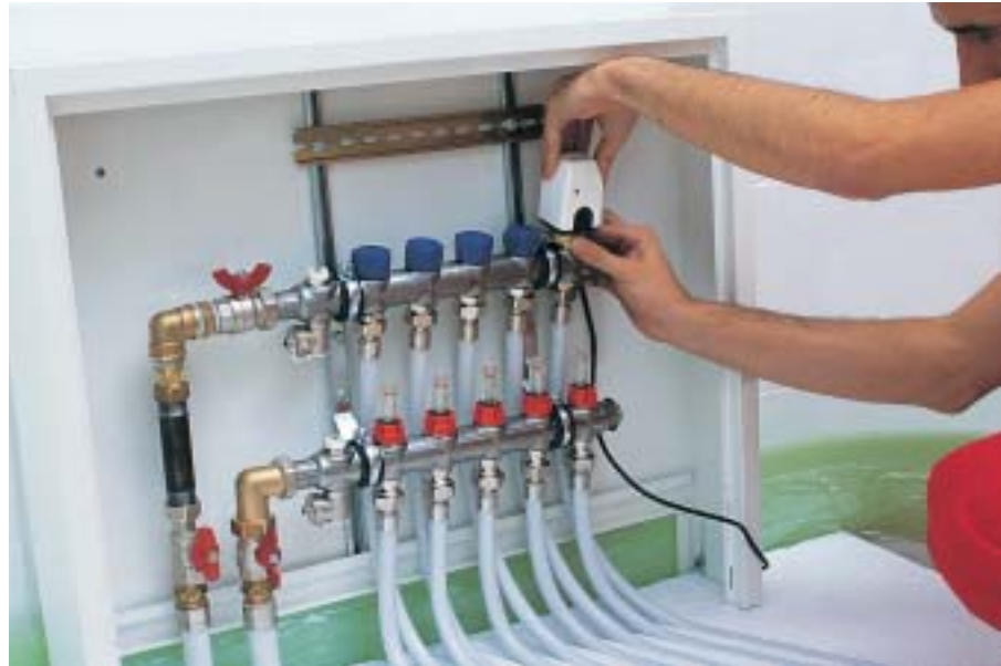
Установка сервоприводов PRINETO
